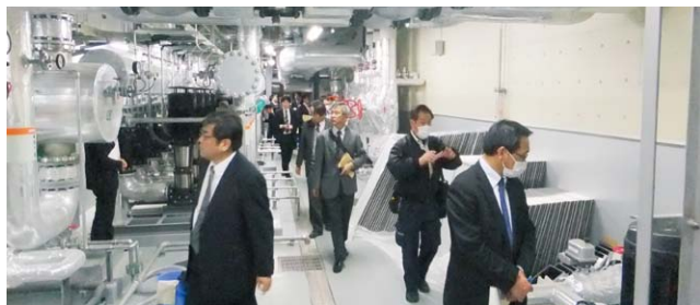
▲熱源システム室
